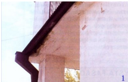
Zacieki w brzegowej strefie tarasu już po kilkuletniej eksploatacji tarasu.
